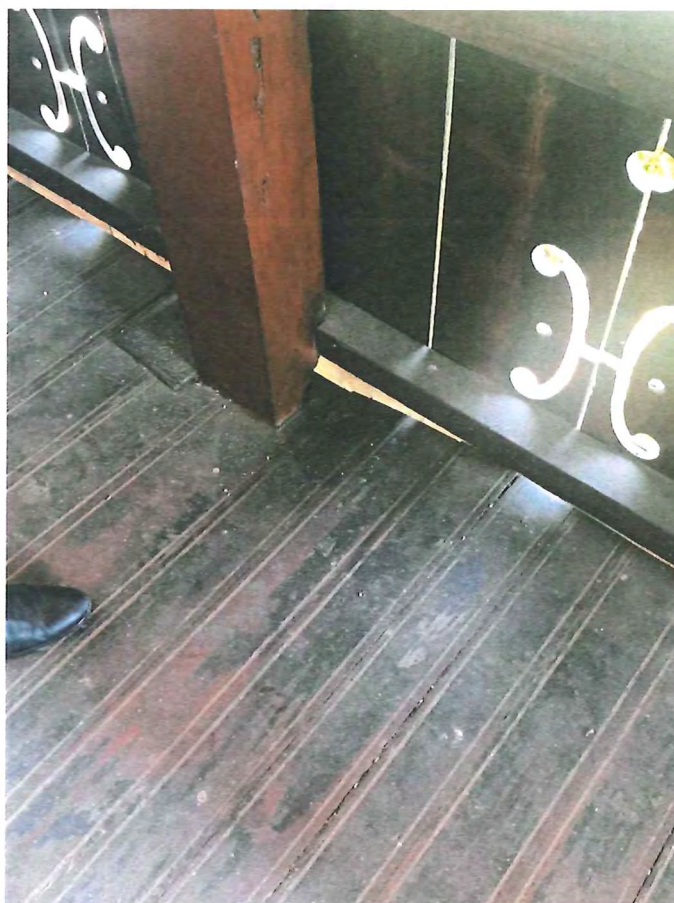
Balcon s'affaissant à l'étage
