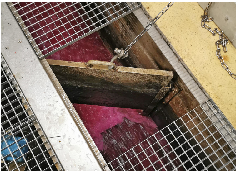
Produit style vin rouge canal entrée dégrilleur
